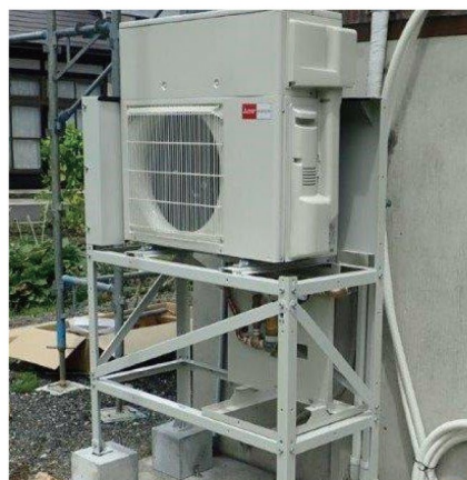
ヒートポンプユニット
